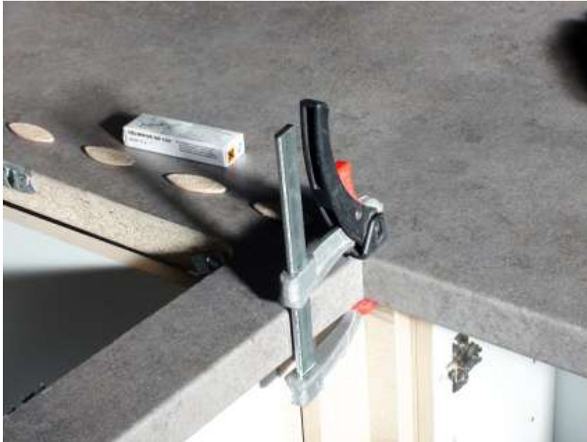
Bild 25. Bündige Verleimung von Arbeitsplattenstoßfugen.
